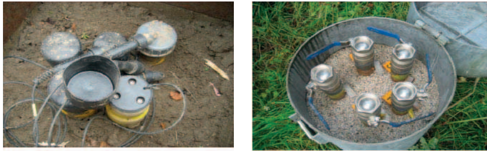
FIGUUR 3.5 PEILBUIZEN AFGEWERKT MET BEVEILIGDE DOP EN WATERDICHTE KAP (LINKS) EN MET KOGELKRAAN (RECHTS) (BRON: LEUNK, I. E.A., 2011)
