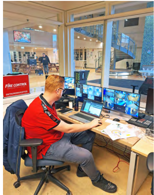
De centrale controlekamer
